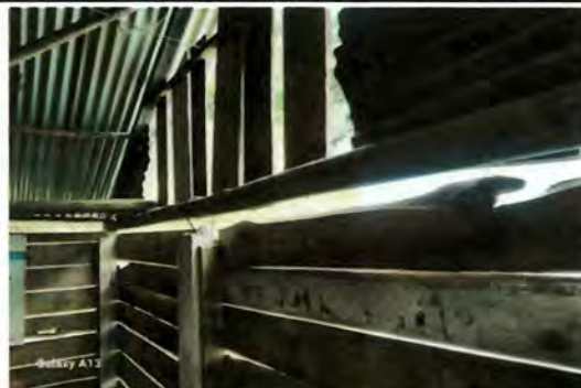
Foto 2: Estructura de techo de madera y en mal estado, con el remozamiento se estará cambiando por estructura de metal.
