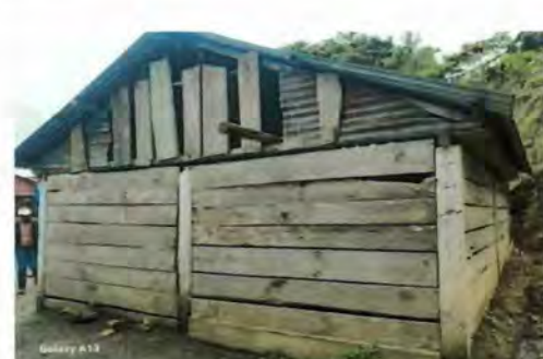
Foto 4: Se observa la estructura de paredes de la cocina actual de la escuela lo que las tablas se encuentran en mal estado por lo que es urgente cambiar por paredes de block.
