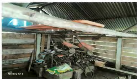
Foto 3: En la imagen se observa el piso en mal estado y la estufa en mal estado, se sustituirá el piso de concreto y se colocará una estufa mejorada.
