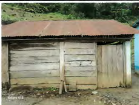
Foto 1: Cubierta de lámina en mal estado, se plantea cambiar por láminas troqueladas.
