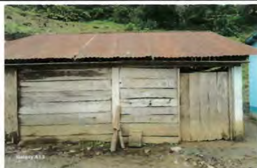
Foto 5: La puerta actual es de madera y con el paso del tiempo se ha ido deteriorando, por el bienestar de la comunidad escolar es necesario colocar puerta de metal.
